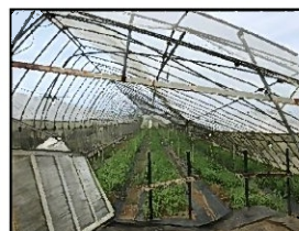
農業施設破損
